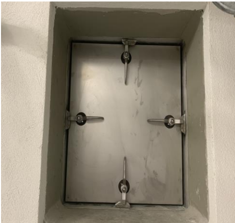
zudrückende Einbausituation, Öffnung in den Tank Außenseite
