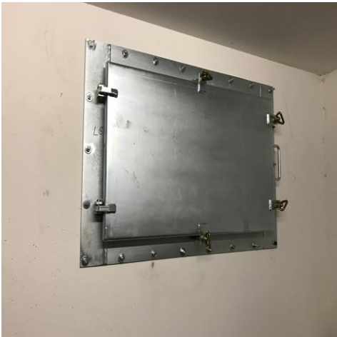
aufdrückende Einbausituation Außenseite
